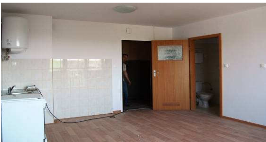
Nowy budynek komunalny u zbiegu ulic Łukasieńskiego i Świętochowskiego - ostatek prace wykończeniowe
