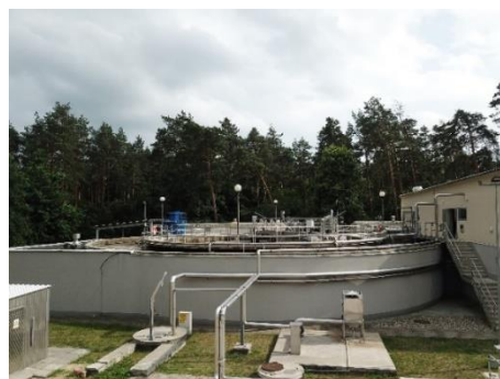
Reaktor oczyszczalni ścieków
