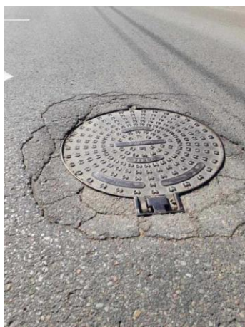
Zapadnięty właz w asfalcie
