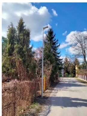
Oświetlenie ul. Lipowa
