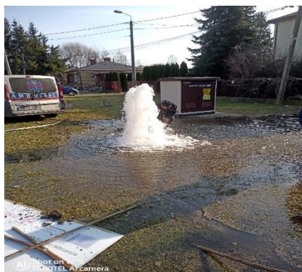
Usuwanie awarii wodociągowej spowodowanej przez samochód.
