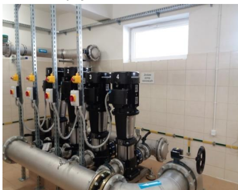
Stacja Pomp sieciowych SUW II.
