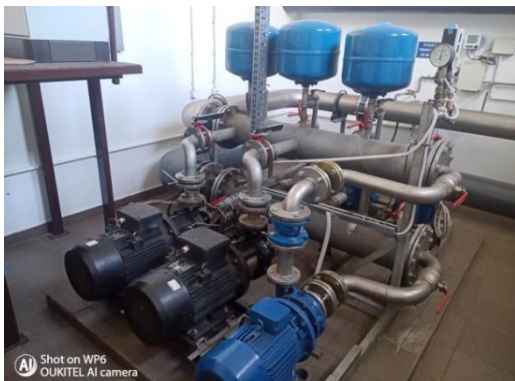
Stacja pomp SUW I.
