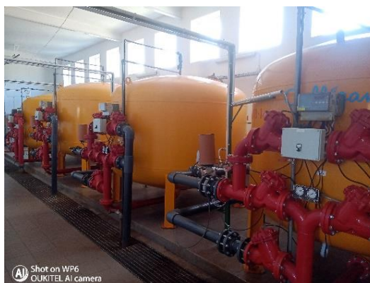
Fot. 3 – Hala filtrów SUW I.
