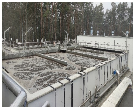
Zdjęcie 18. Oczyszczalnia ścieków Nowy reaktor
