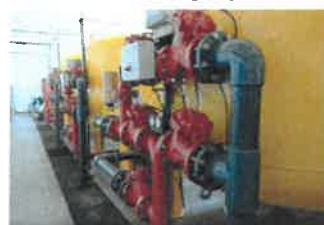
Fot. 4 – Hala filtrów SUW I
