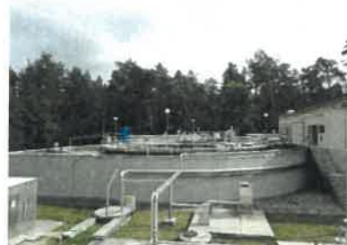
Fot. 14 – Reaktor oczyszczalni cieków
