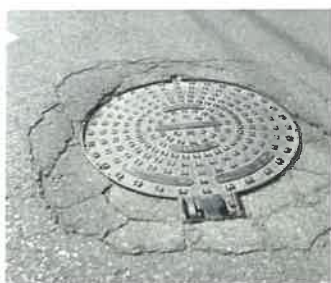
Fot. 19 – Zapadnięty włącz w asfalcie
