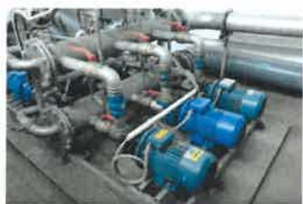
Fot. 3 – Stacja pomp SUW I
