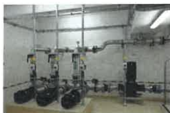
Fot. 7 – Stacja pomp SUW II
