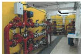
Fot. 8 – Hala filtrów SUW II
