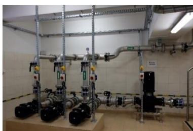
Stacja pomp SUW II
