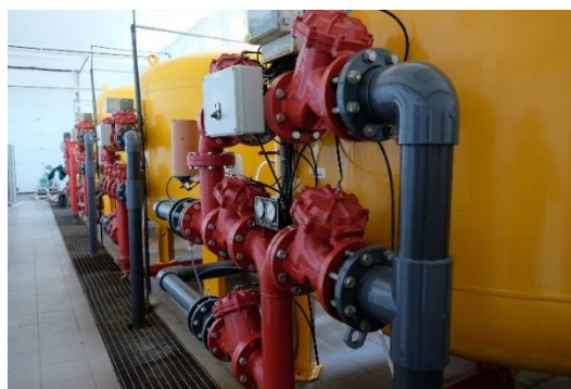
Hala filtrów SUW I
