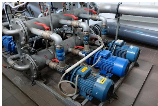
Stacja pomp SUW I
